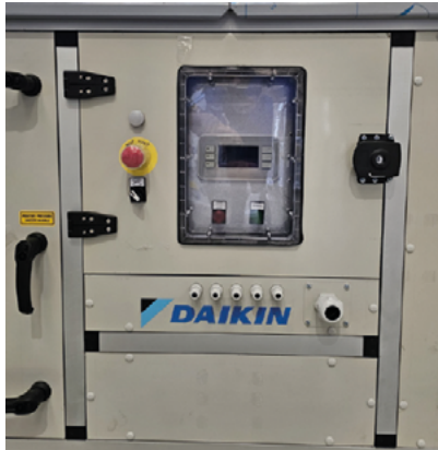
Q. E. Digital Internal (unutarnja digitalna električna ploča)
